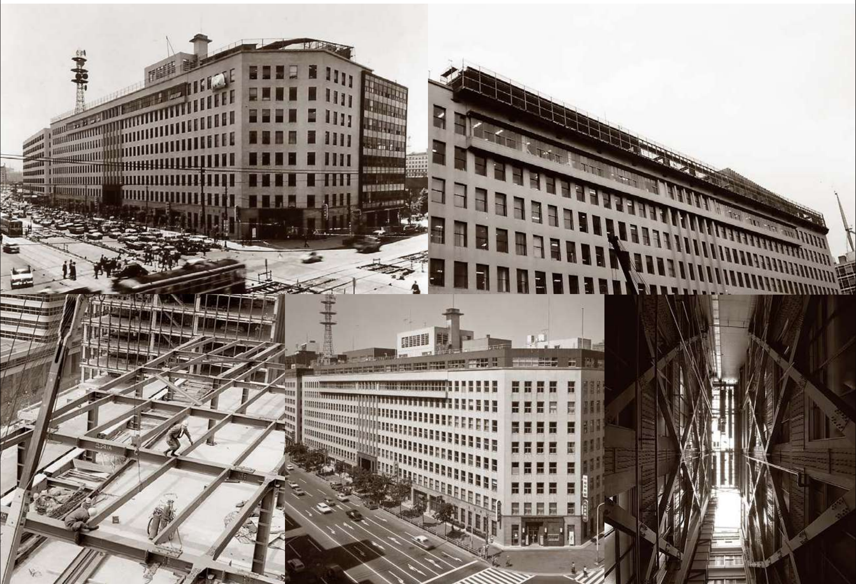
既存の建物部分に影響が出ないよう細心の注意を払って行われた増築・耐震工事
